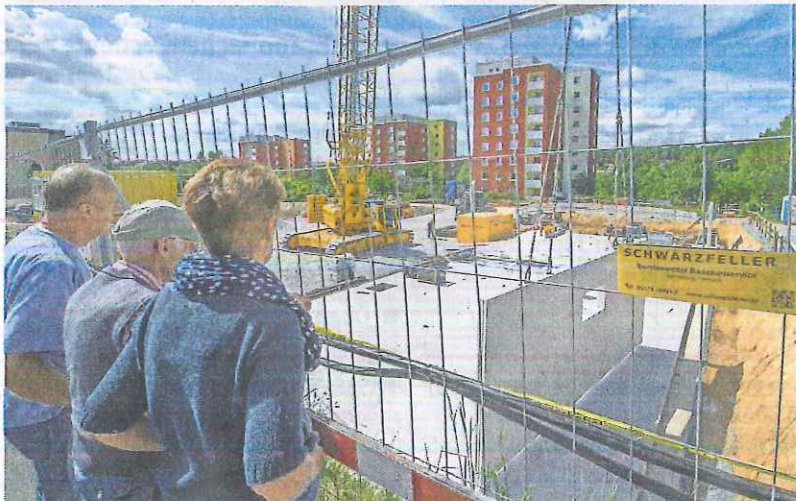
Den Baufortschritt des Studenten-Wohnheims betrachten die Anwohner der Wirthstraße mit Interesse. Foto: Jochen Bake
